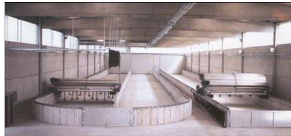
Reactor rectangular horizontal con volteadores
